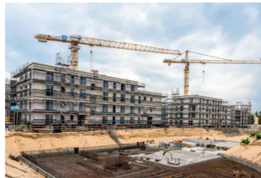
Nach der Fertigstellung des Rohbaus in einem Baufeld wandert die Rohbaukolonne samt Material und Geräten ins nächste Baufeld
